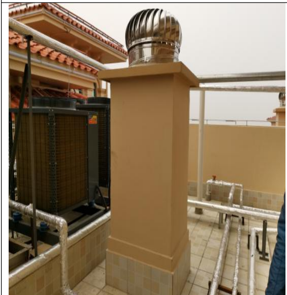
项目（A1 地块）楼顶内置烟道排口
