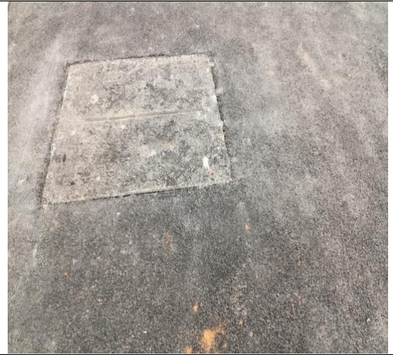
项目（A1 地块）125m 3 雨水收集池
