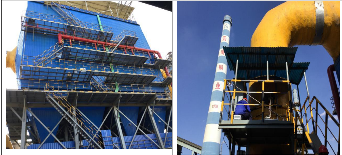
项目100m 2 电除尘系统
