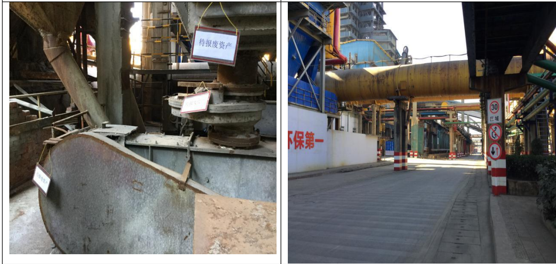
项目原2#除尘器待报废标识
